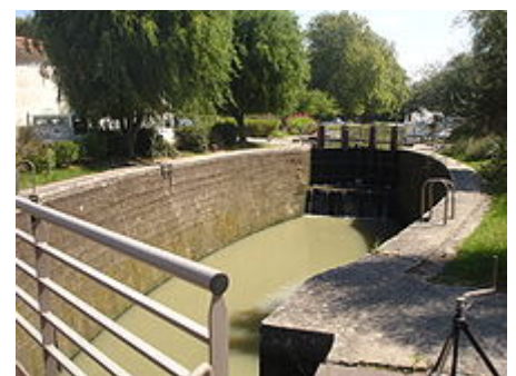
Écluse de Nègre avec ses bajoyers arrondis caractéristiques du canal du Midi.
